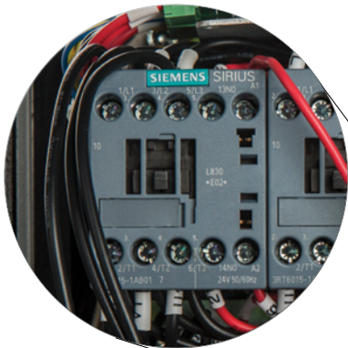
SIEMENS besturingssysteem / SIEMENS relais
